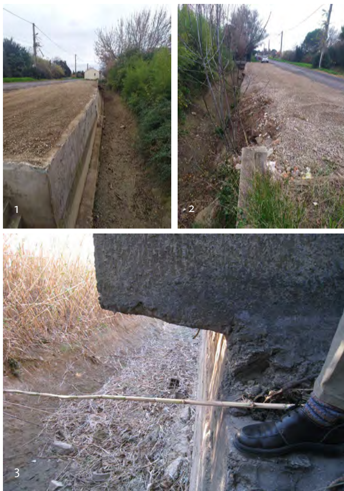
1 : AVANT - Constat empiètement maison sur canal 2 : APRÈS - Destruction maison sur canal 3 : Constat empiètement maison sur canal Union Est Audois
